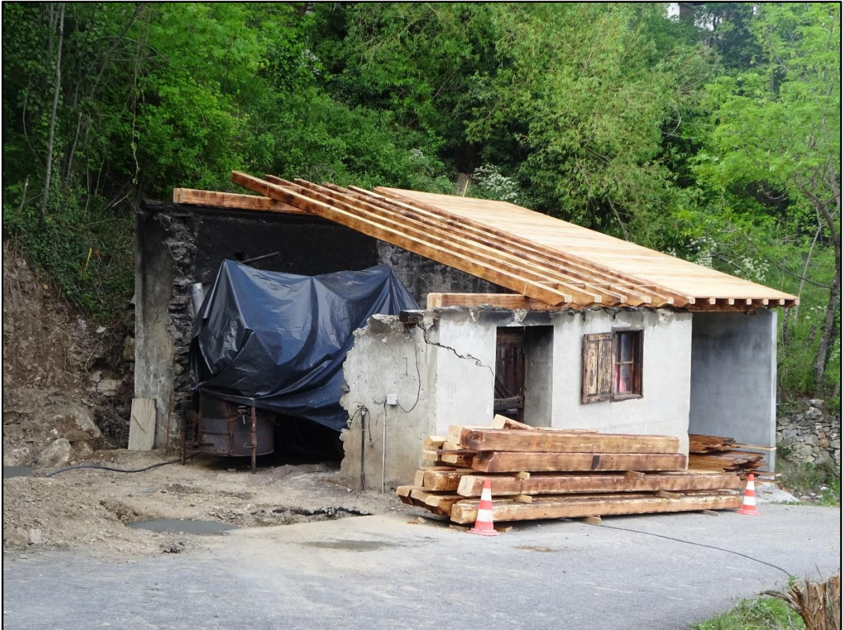
Image 33 : état général à J + 2
