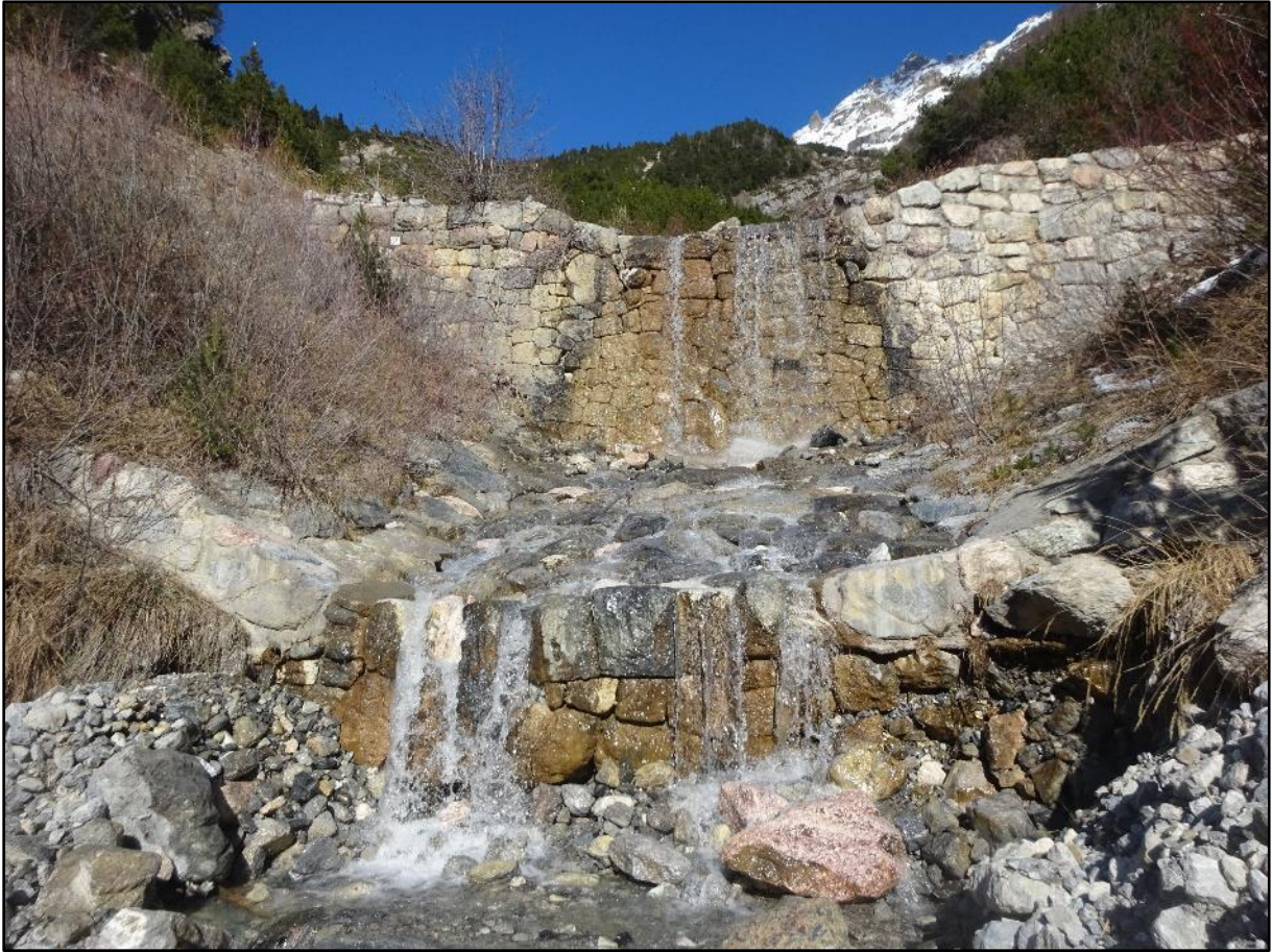
Image 11 : au pied du troisième seuil
