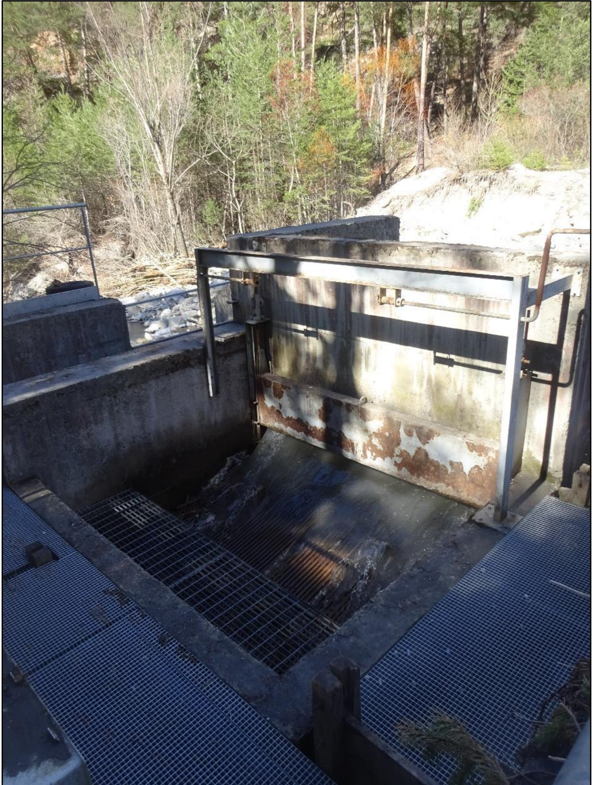
Image 3 : au captage de la microcentrale
