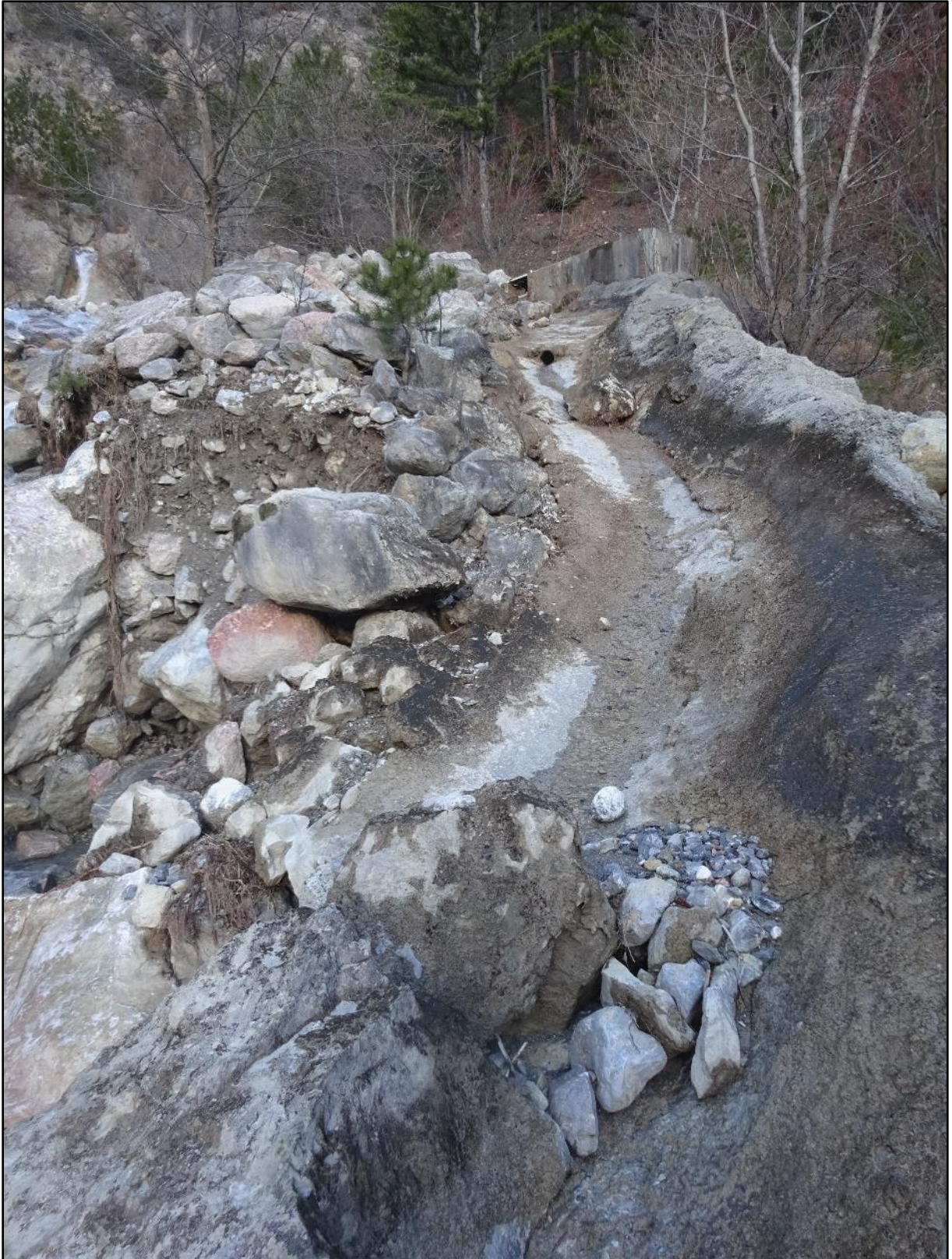
Une goulotte bétonnée dans le sens de la pente et un captage en rive droite.
