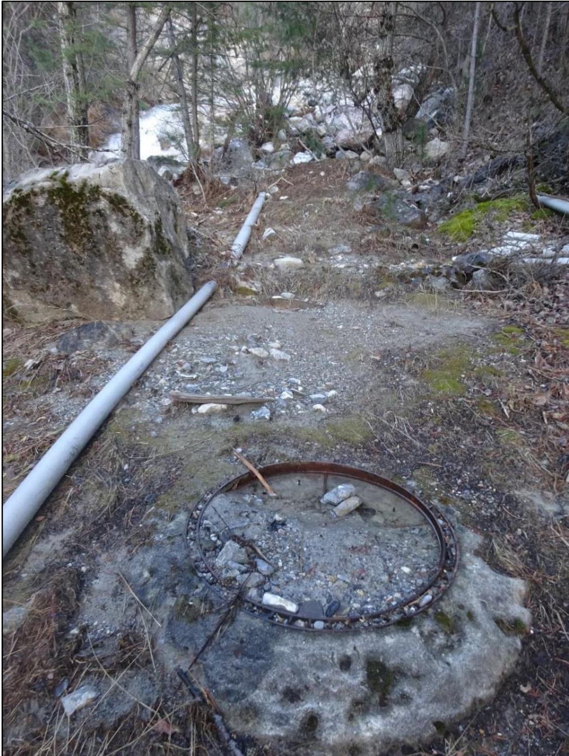
Image 6 : une canalisation souterraine
