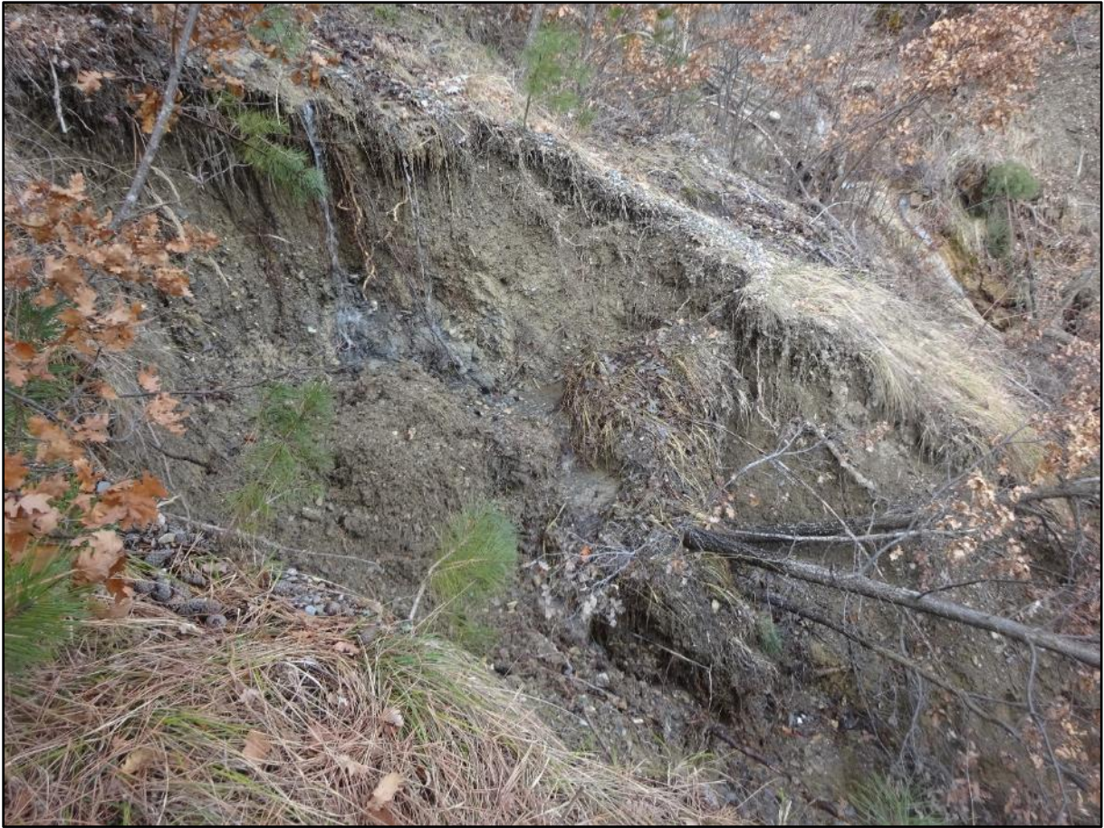
Image 13 : suite de l'éboulement
