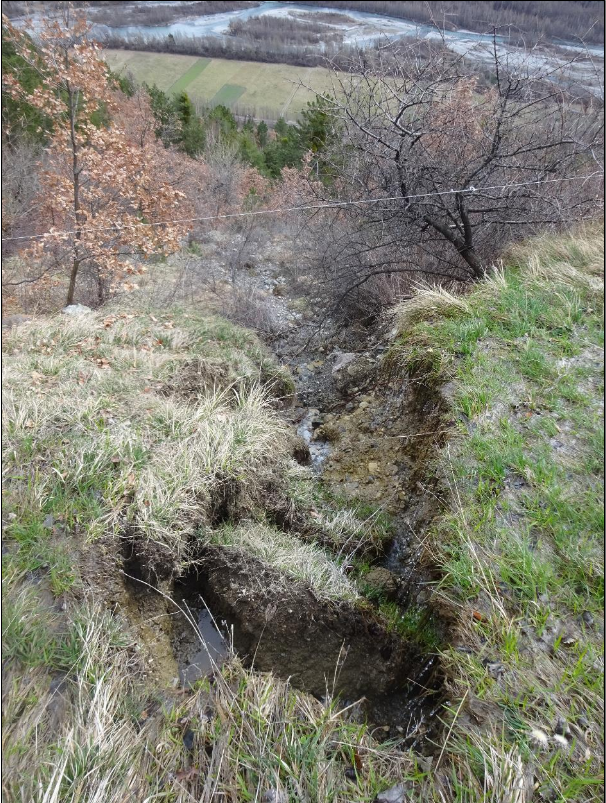
Image 8 : au bout de la fissure
