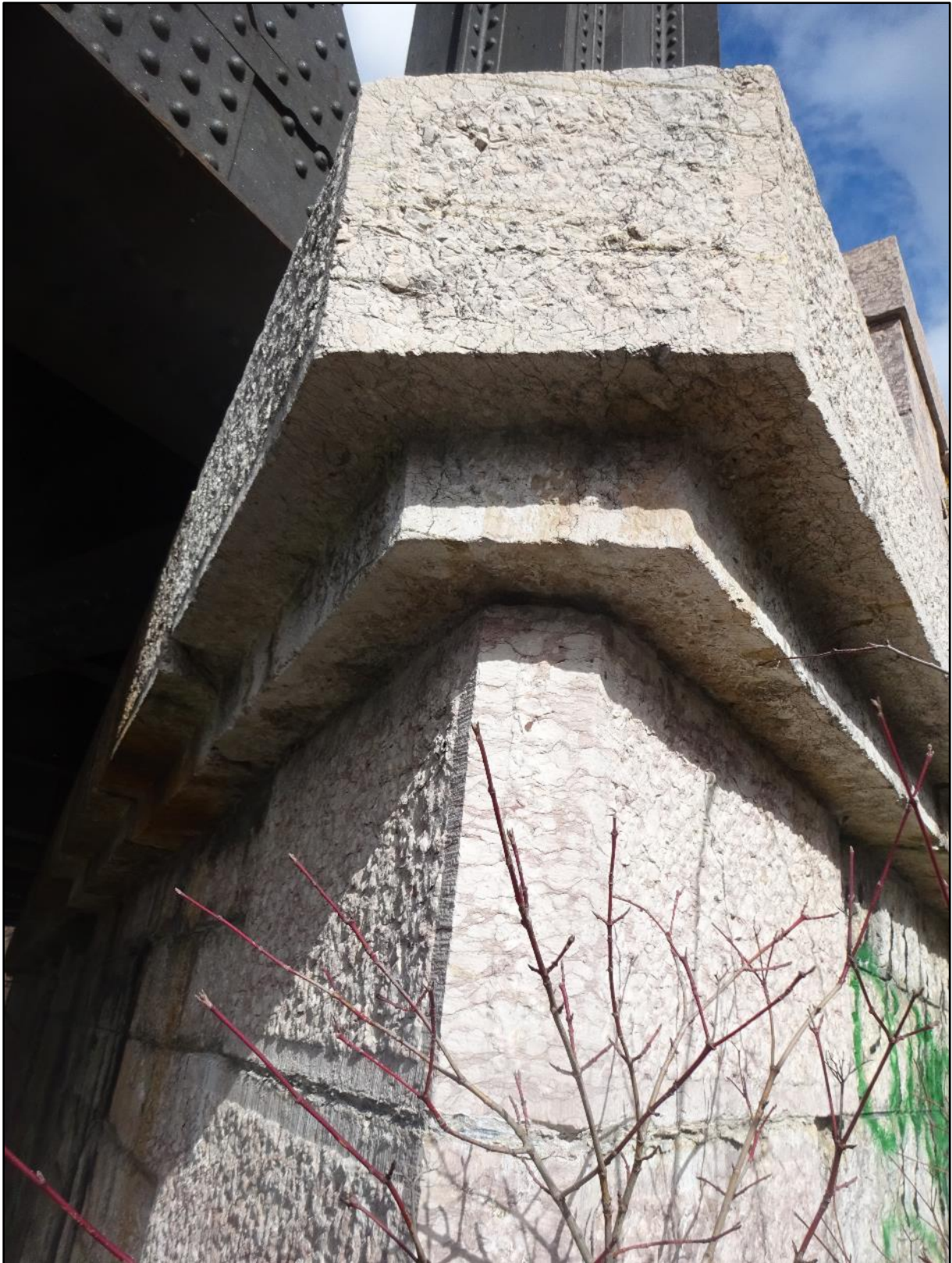
Assemblage de la pierre et du métal pour faire un pont sur la Durance.
