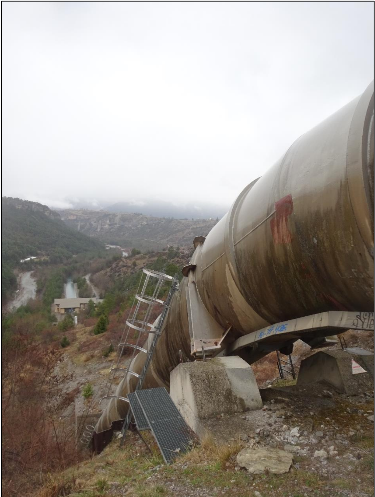
Image 5 : la conduite et la centrale
